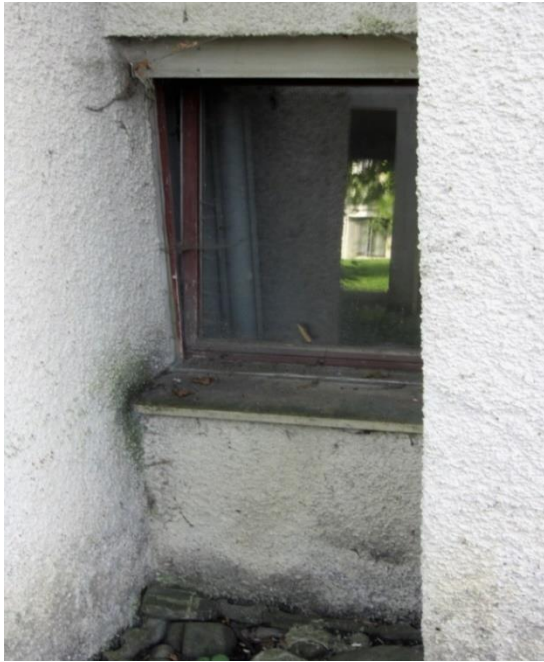
Abb. 85 2015: Schulhaus Riethüsli 2, schimmelig.
