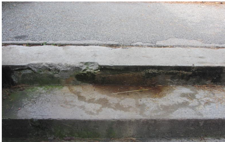
Abb. 84 2015: Einer der offensichtlich gravierenden Mängel, Treppe zum Schulhaus Riethüsli 1.
