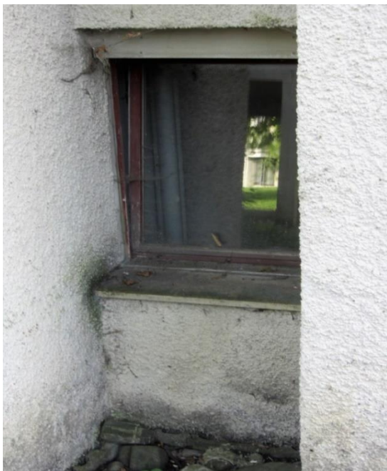
Abb. 85 2015: Schulhaus Riethüsli 2, schimmelig.
