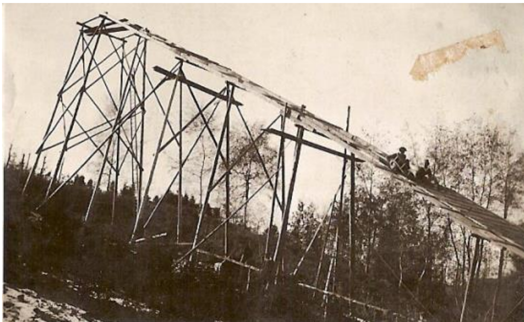
Abb. 106 1928: Vermutlich erste Aufnahme vom Bau des Anlaufsturms. Freiwillige errichten mit Fantasie und Herzblut – aber ohne SUVA-Vorschriften – den ersten Anlaufsturm. StadtASG
