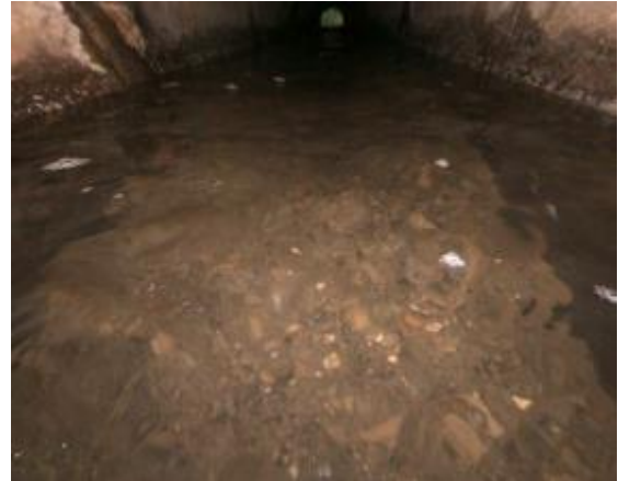
Geröllablagerungen an der Sohle im Rohr
