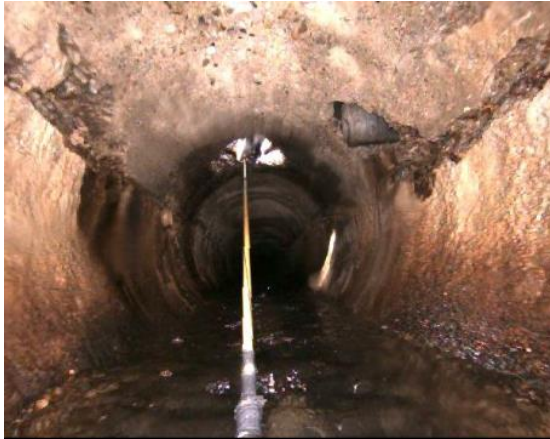
Risse, Scherben und unverputzte Einläufe
