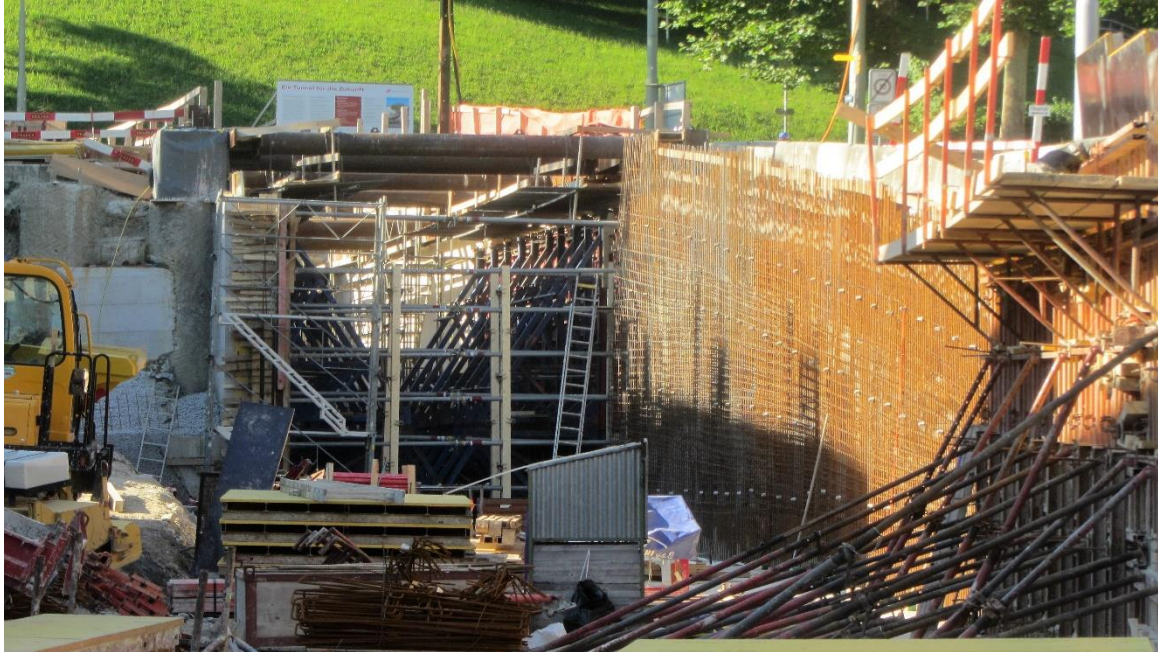
Abb. 167 Herbst 2016: Mit Hochdruck wird das südliche Tunnelportal bei der Busendstation im Riethüsli vorbereitet.
