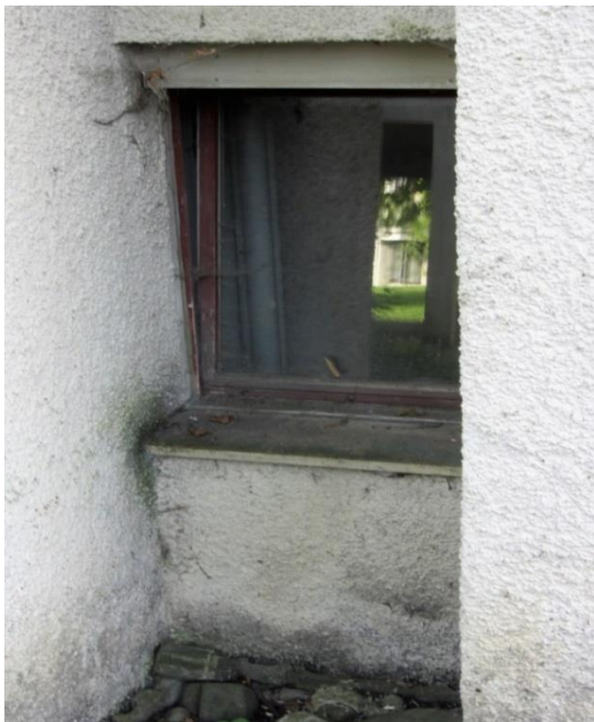
Abb. 85 2015: Schulhaus Riethüsli 2, schimmelig.
